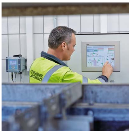
廢水廠PLC操作
