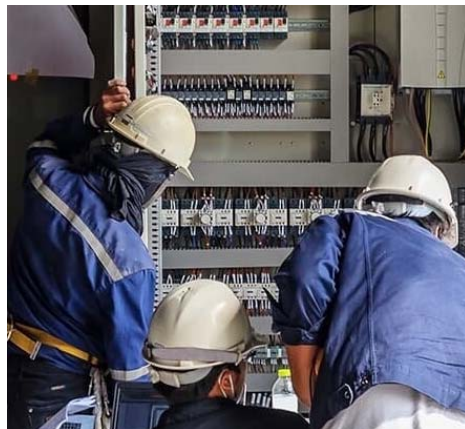
再生水廠PLC維護
