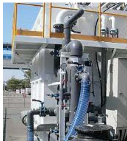
MBR槽操作維護
