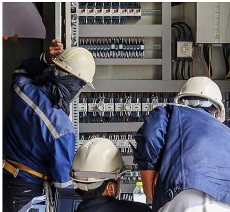
再生水廠PLC維護
