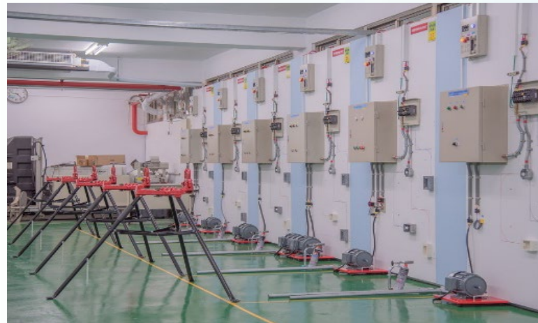
配管配線實習工廠(E棟)
